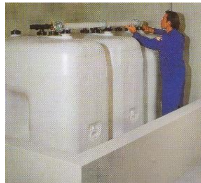
D) spremnici u zaštitnom bazenu
