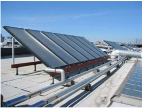
Slika 41. Solarni sustav s grupama kolektora montiranim na krovne nosače [12]
